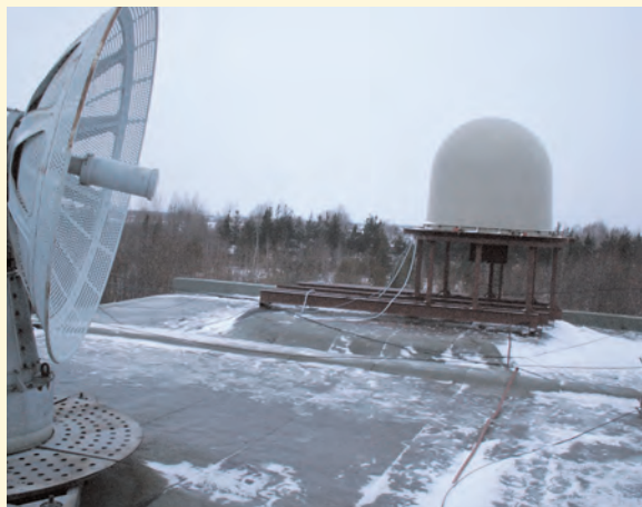
Аэрологические радиолокаторы МАРЛ-А и АВК на крыше здания АЭ, (г. Архангельск)
