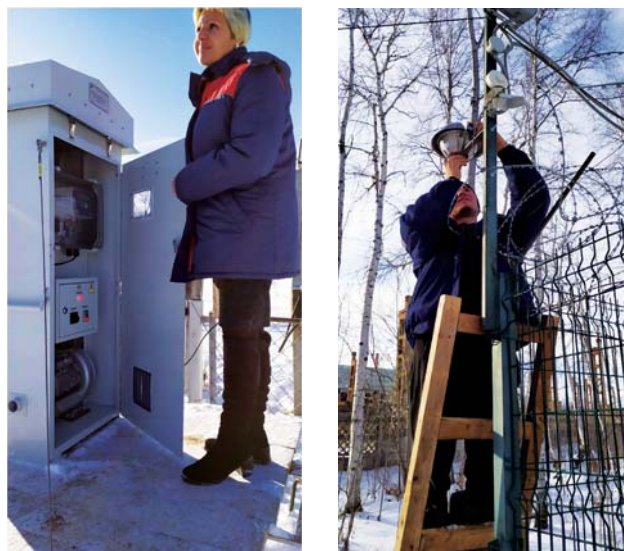
Слева на фото установка воздухофильтрующая МР-48-01 для отбора проб на СОЗ; справа – установка пассивного пробоотборника на СОЗ на метеостанции г. Байкальск
