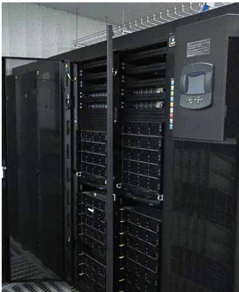
Фрагмент серверной подсистемы высокопроизводительного вычислительного комплекса Росгидромета
